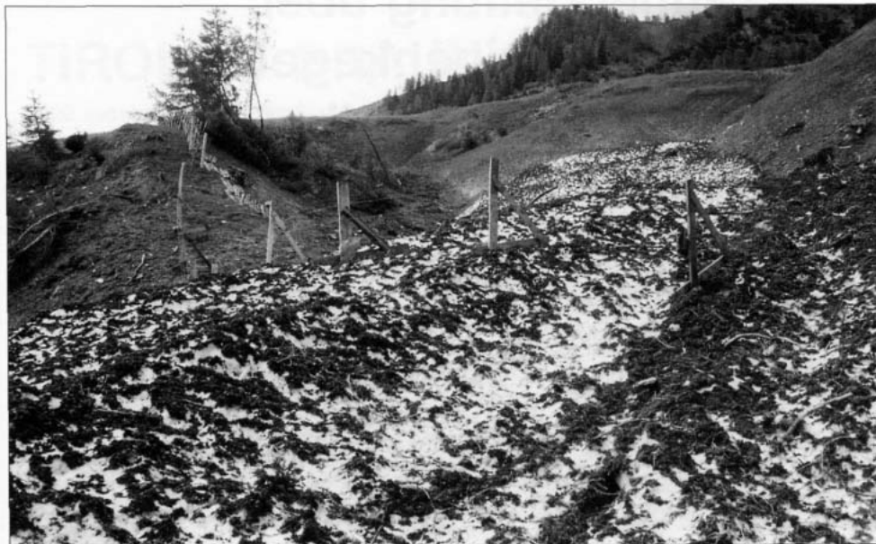
Der über einen Lawinenkegel mit Dreiecksrahmen erstellte Zaun ist sehr wenig wartungsaufwendig
