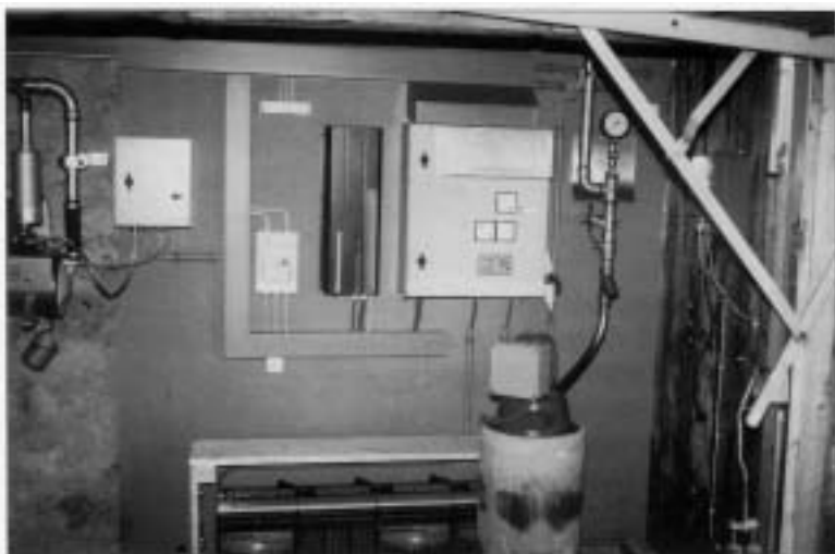
Stromversorgungsanlage auf der Alp Inner- Urden in der Schweiz
