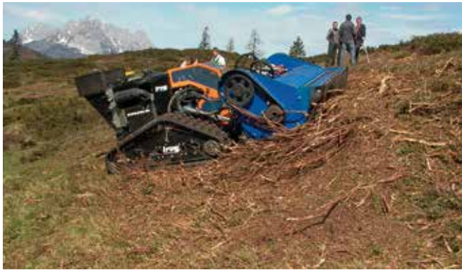
Abbildung 116: Der Einsatz ferngesteuerter Schlegelgeräte bietet Komfort und Sicherheit für den Arbeiter. (© eb&p Umweltbüro GmbH)
