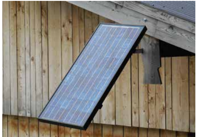
Abbildung 48: Mit Hilfe einer Photovoltaikanlage kann aus Lichtenergie Strom erzeugt werden. (© Stefan Hellebart)
