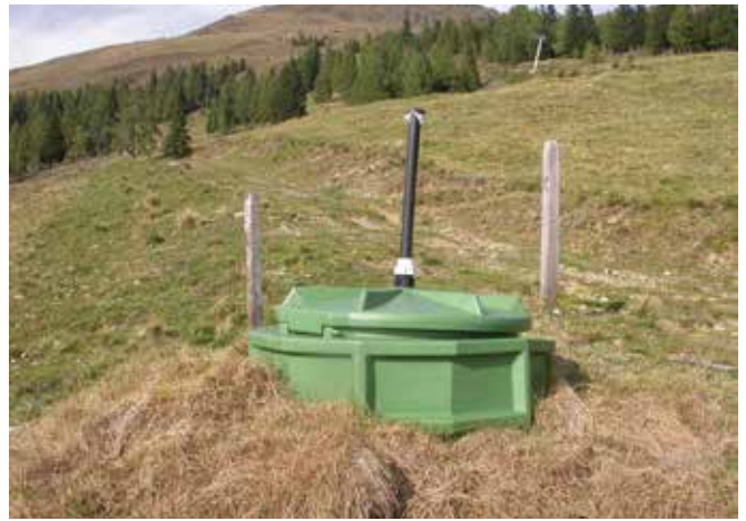
Abbildung 56: Ein Quellschacht in Kunststoffausführung (© Stefan Hellebart)
