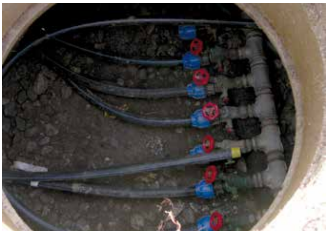
Abbildung 59: Ein offener Verteilerschacht – die einzelnen Wasserleitungen führen zu den Almhütten; in den Wintermonaten können die Wasserleitungen entleert werden. (© Stefan Hellebart)
