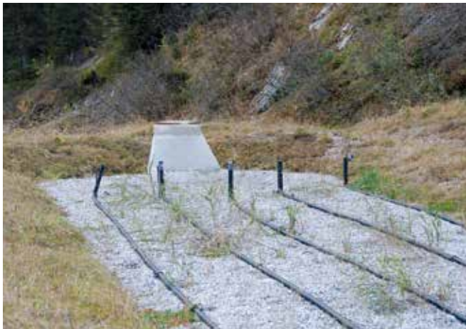
Abbildung 87: Neu errichtete Pflanzenkläranlage auf einer Alm (© Stefan Hellebart)
