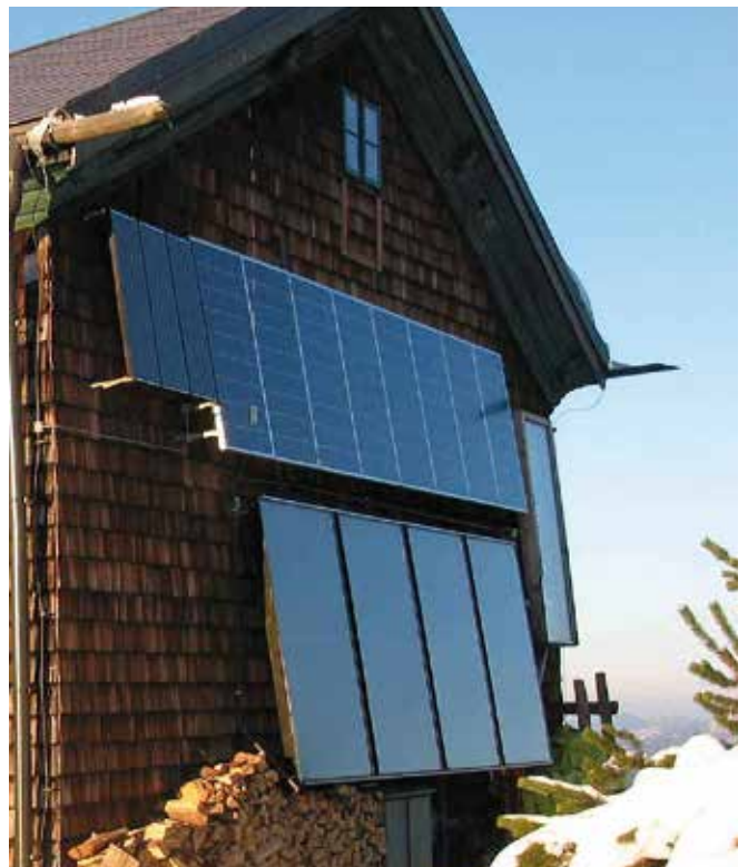
Abbildung 49: Eine Photovoltaikanlage und Sonnenkollektoren an der Außenwand einer Hütte (© Franz Legner)
