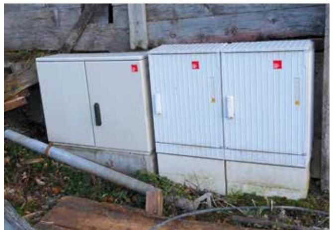
Abbildung 46: Stromschaltkästen (© Stefan Hellebart)
