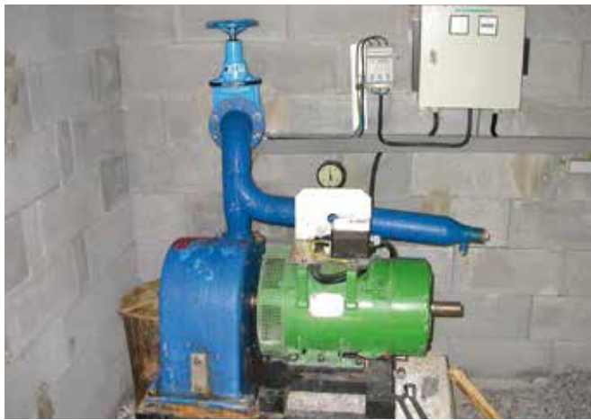
Abbildung 47: Turbine und Generator eines Kleinwasserkraftwerks (© Stefan Hellebart)
