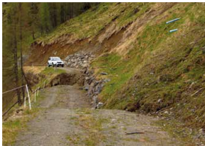
Abbildung 10: Geotechnische Probleme (© Friedrich Walter Merlin)
