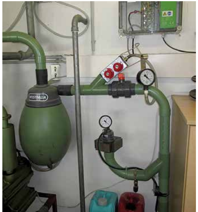
Abbildung 20: Überprüfung der Pumpenleistung (© Josef Mallaun)
